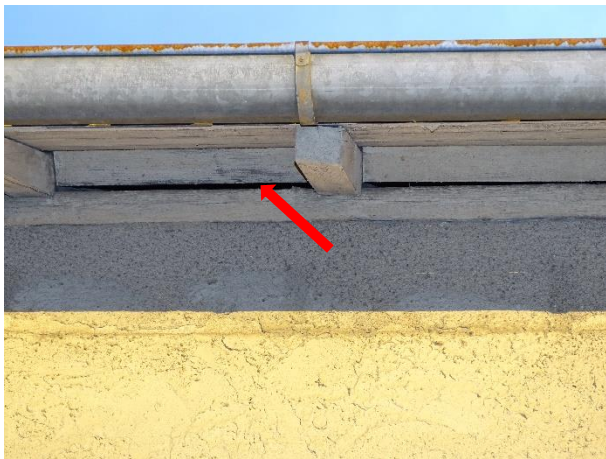
Abb. 6: Spalt am Dachtrauf der Werkshalle
