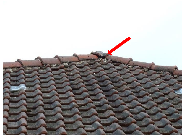
Abb. 5: Abstehende Ziegel am Dach der Werkshalle
