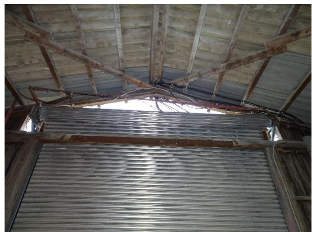
Abb. 9: Einflugmöglichkeit zwischen Lagerhallentor und Dachkonstruktion
