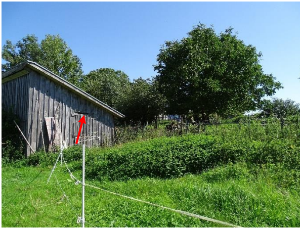
Abb. 10: Spalt (roter Pfeil) an einer Tür der Scheune auf Flst.-Nr. 1070
